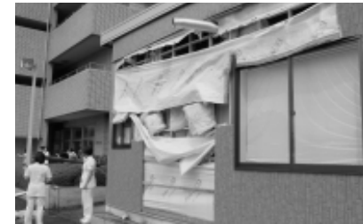
●被害にあったリハビリテーション室の別棟
